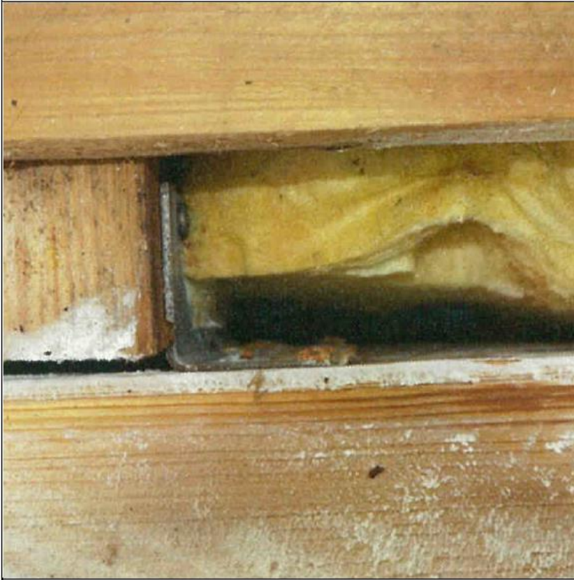
Abb. 19: Lücke zwischen Sparren und Wärmedämmung ermöglicht Konvektionsströmungen
