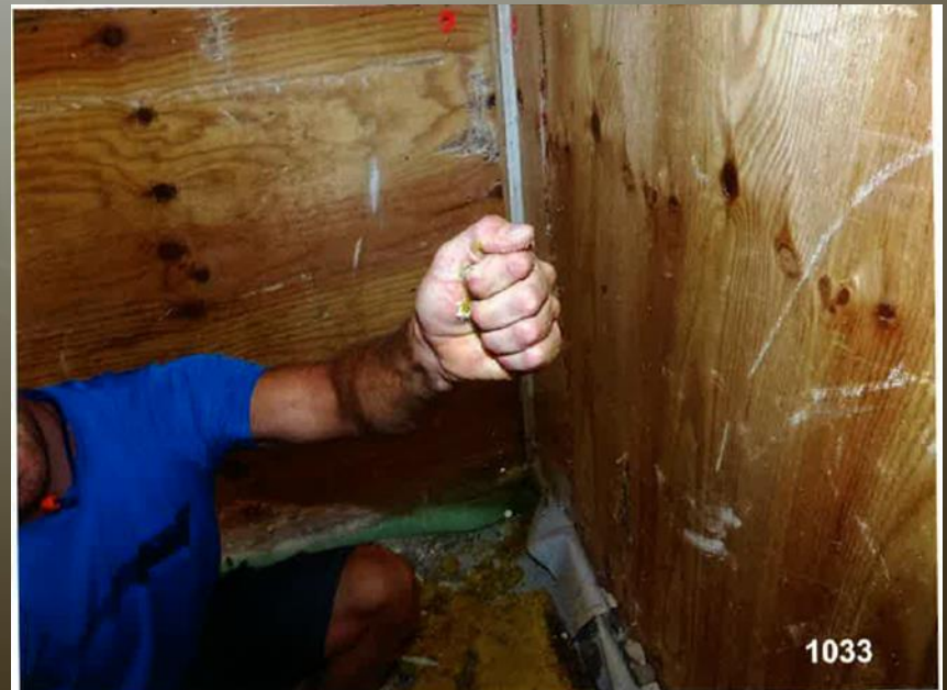
Foto #1033 nasse Trittschalldämmung.
